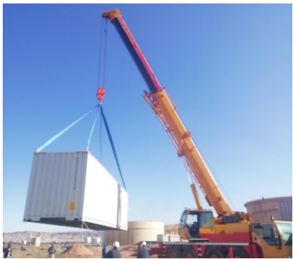
传统集装箱式储能需要吊车安装
