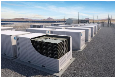
集装箱式储能系统示例
